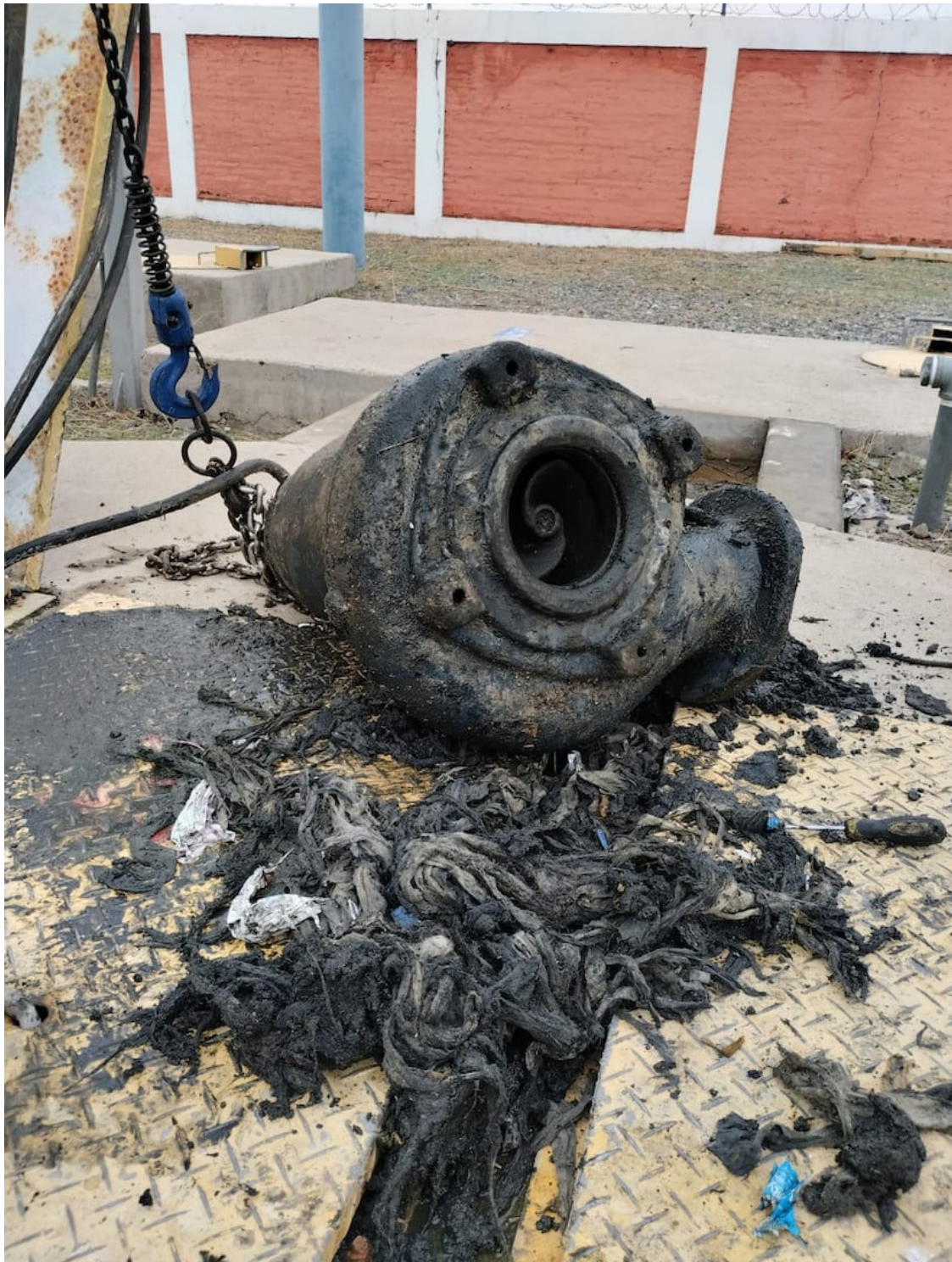
Basura extraída de las alcantarillas. Aguas Andinas
