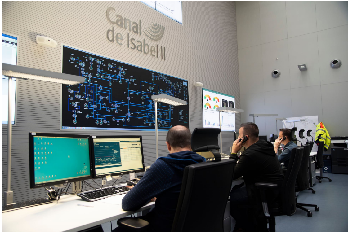
Centro de control del Canal de Isabel II. M. Angel Gomez Canal de Isab
